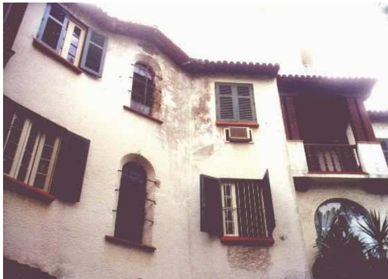
Fig. 17 – Fachada principal com marcas de infiltração e diferentes texturas
